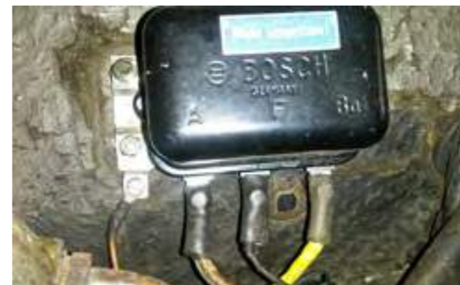
Repérage du joncteur.
